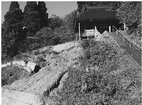
崩壊したのり面
