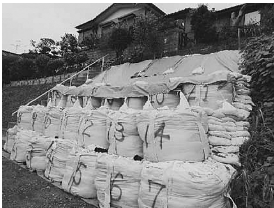
星の宮町地内のり面崩壊現場
