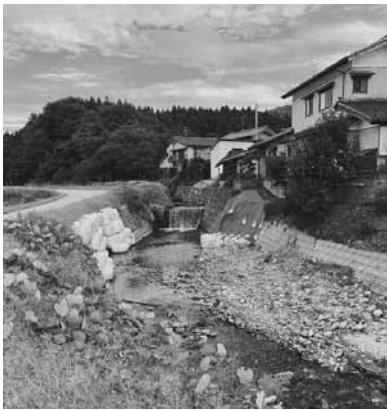
舟戸川の破損した護岸
