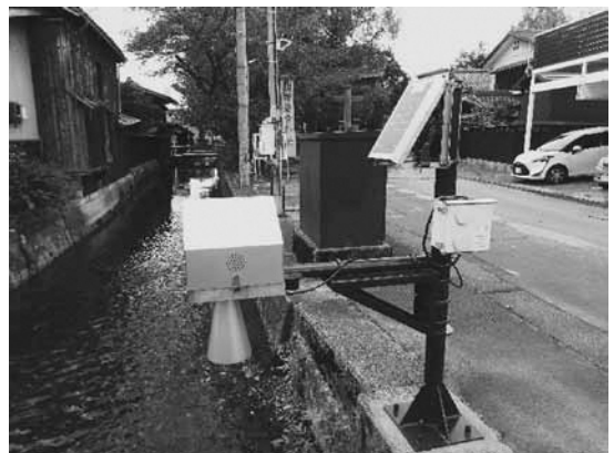
危機管理型水位計（柴橋川）
