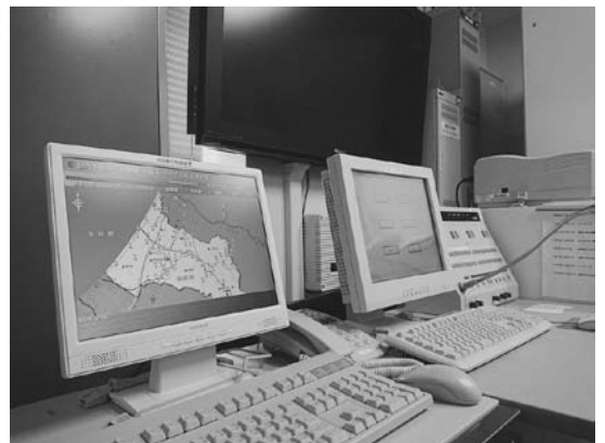
防災行政無線システム
