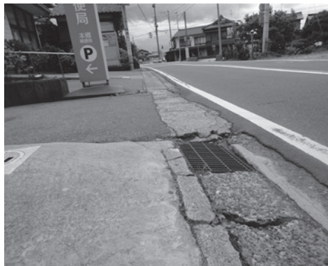
事故現場近くの段差が多い側道
