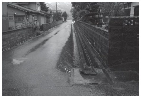
側溝が深く危険な道路
