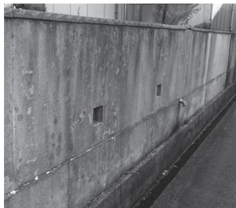
道路脇のブロック塀
