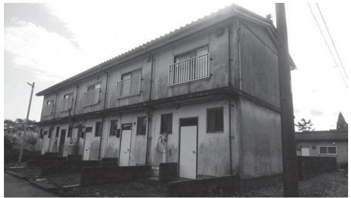
老朽化した公営住宅
