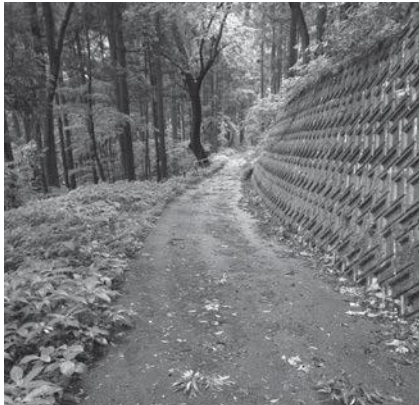
現在通行止めになっているサイクリングロード・遊歩道
