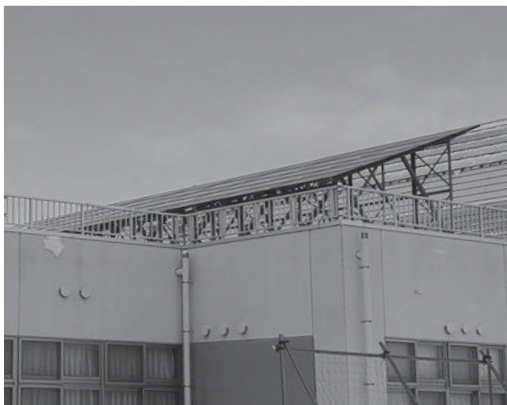
胎内小学校太陽光パネル
