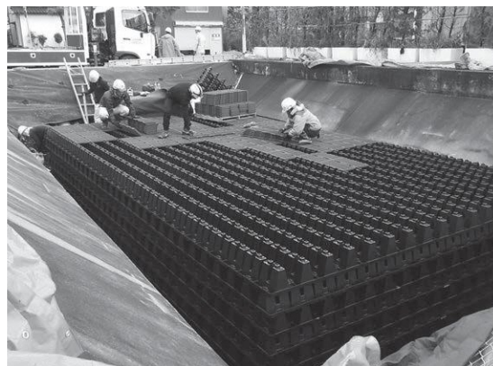
大型貯留浸透槽
