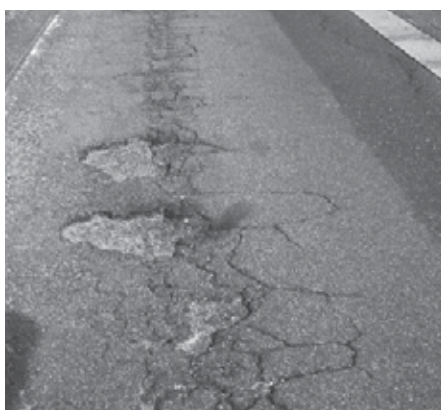
亀裂、剥離した道路
