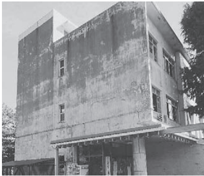
老朽化が進んでいる胎内市図書館
