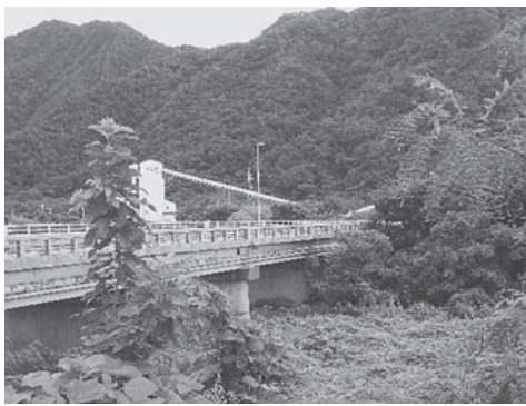
雑木が繁茂している黒川橋
