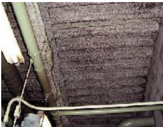
石綿含有吹付けロックウール
