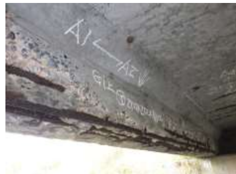
コンクリート橋の剥離・鉄筋露出等 (無名橋 312-1)
