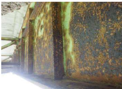
鋼桁の腐食等 (改修橋)
