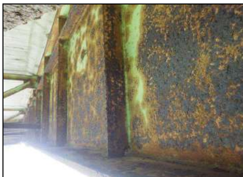
鋼桁の腐食等
