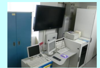
■地域生活基盤施設 防災行政無線整備
