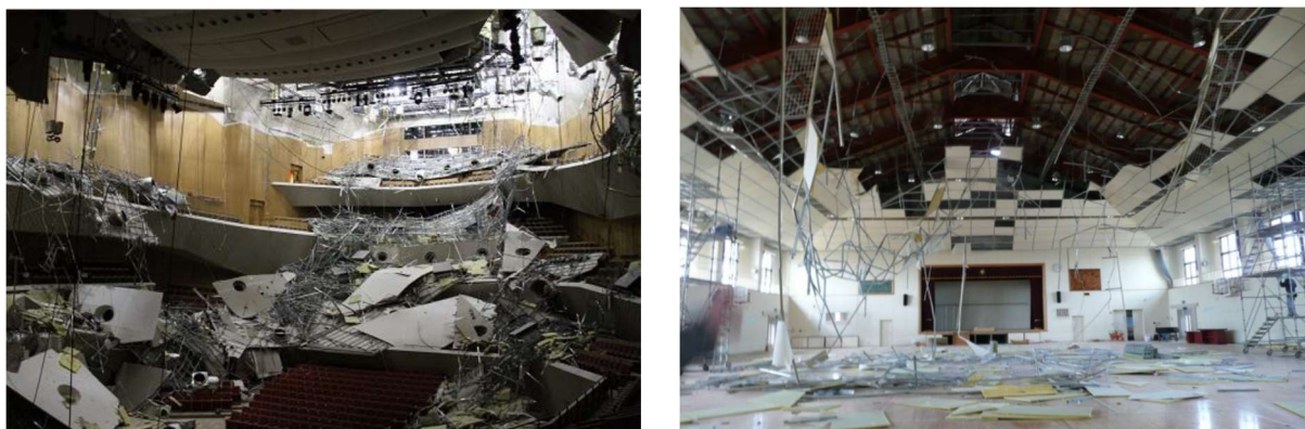
図 3-4 天井材の落下による被害の状況
