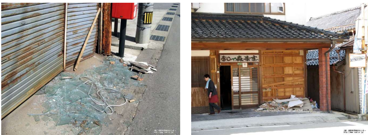
図 3-3 落下物による被害の状況
