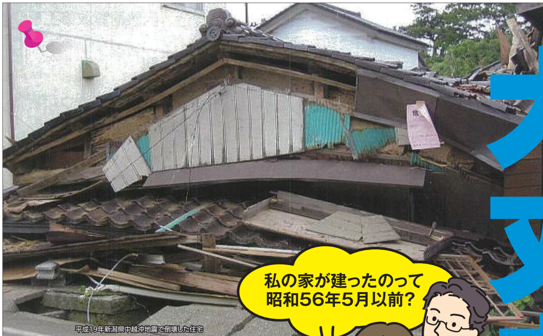
平成19年新潟県中越沖地震で倒壊した住宅
