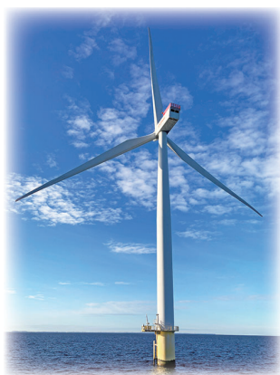
撮影：日本風力発電協会
